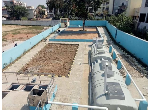
パイロット地区に設置された浄化槽 (順調に稼働しています)
