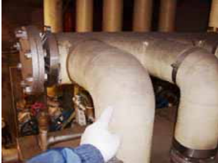
設備 配管保温材
